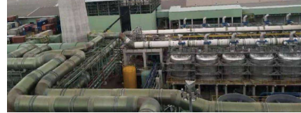
석유화학 플랜트 각종 부식성 매질 이송용 배관
